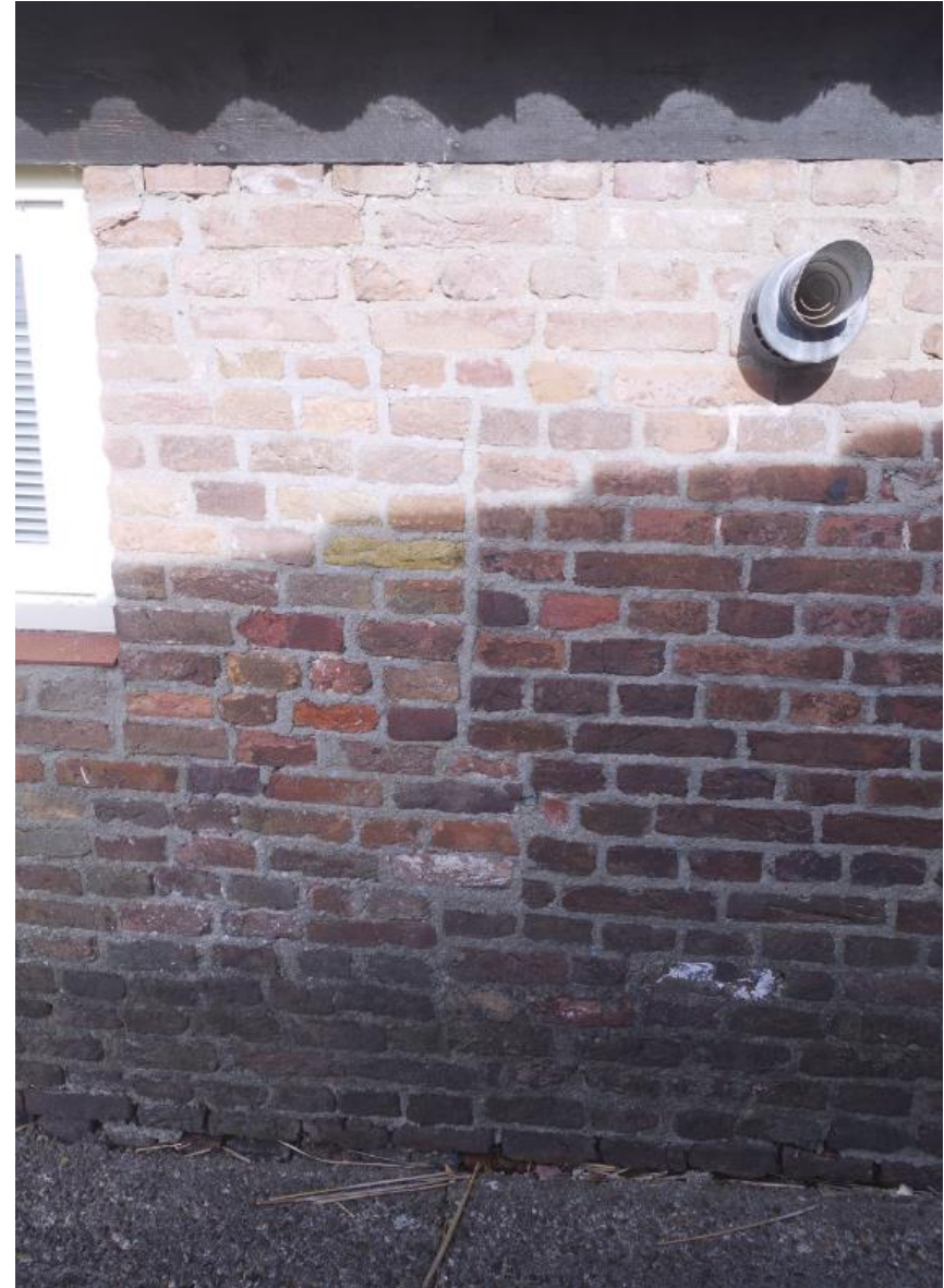
Ter hoogte van de brandmuur is een bouwnaad zichtbaar in het muurwerk van de zuidgevel.
