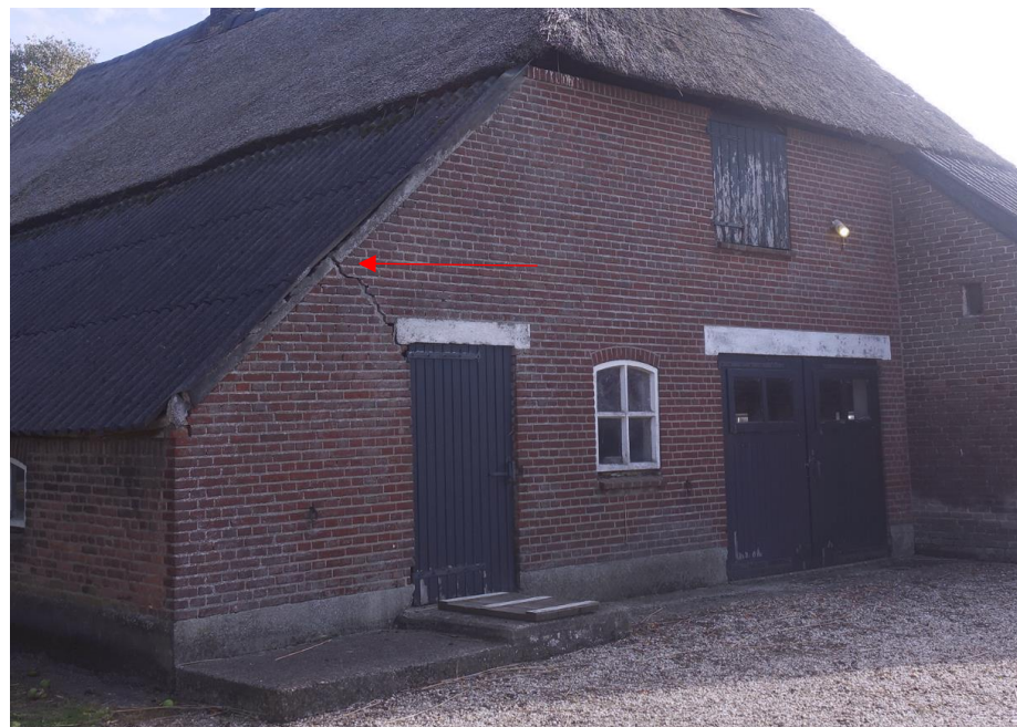
Zicht op de achtergevel van de boerderij die in 1950 opnieuw is opgemetseld. Bij de rode pijl is de scheurvorming aangeven aan de noordzijde van de gevel.
