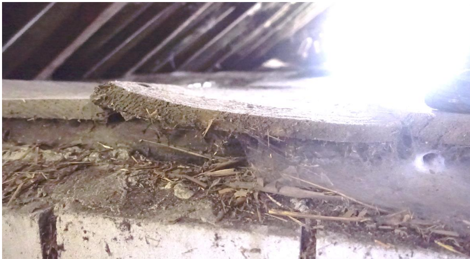
De oude eikenhouten vloerdelen van de zoldervloer boven de noordelijke zijbeuk hebben geen onderlinge verbinding en zijn krom getrokken. Dit doet vermoeden dat het hier om hergebruikt beschoot gaat.
