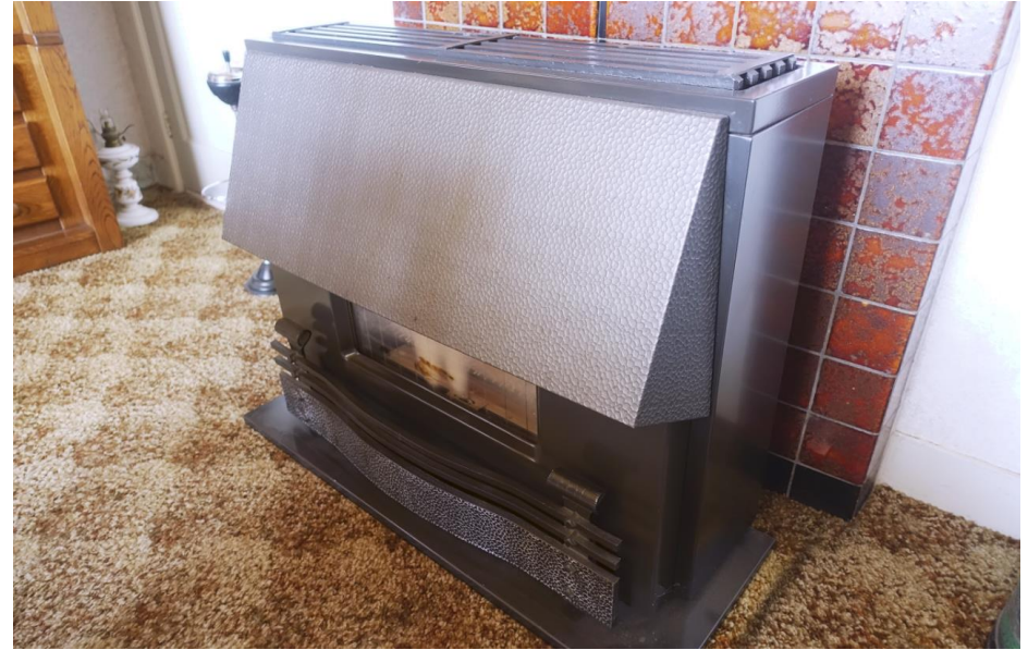
De in 1950 geplaatste gaskachel in de woonkamer.
