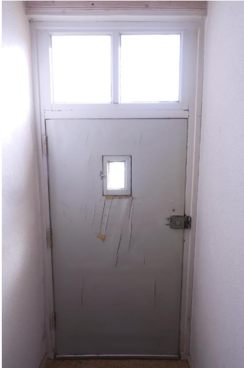
De achterzijde van de voordeur is afgevlakt.
