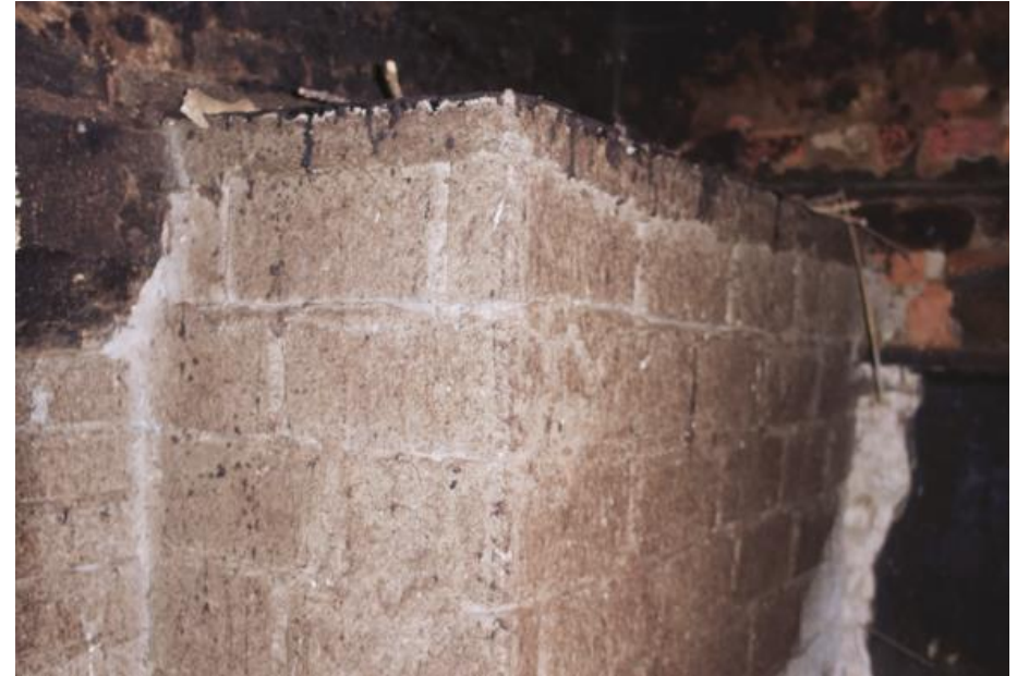
Detail van de betonstenen waarmee de inbouwkasten en de dichtzetting van de haard in de woonkamer zijn opgemetseld.
