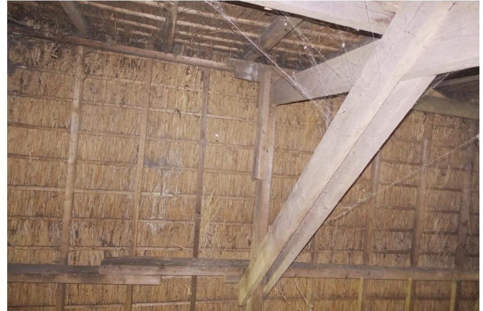
Zicht op de vernieuwde kapconstructie in het achterste deel van de boerderij.
