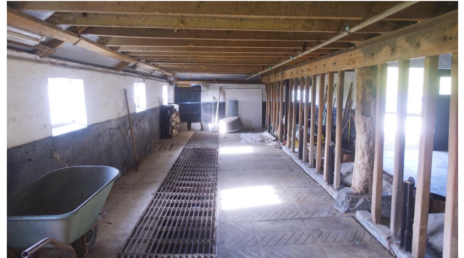
Zicht op de stal in de zuidelijke zijbeuk, met de in 1950 aangebrachte betonnen vloer met mestgoot en voergang en de zolderbalklaag van vurenhout.
