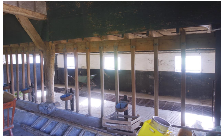
De stalindeling uit 1950 is nog in beide zijbeuken van het bedrijfsgedeelte aanwezig.
