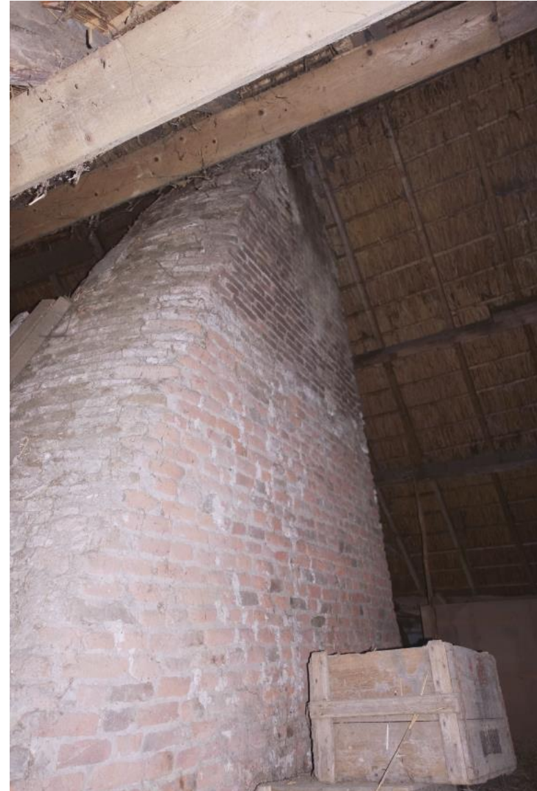
Zicht op de achterzijde van het rookkanaal, ter hoogte van de zolder boven het stalgedeelte. De toegepaste stenen zijn hier wat groter van formaat dan aan voorzijde. Dit doet vermoeden dat er een ouder rookkanaal aanwezig was, vóór de bouw van het huidige kanaal in de achttiende eeuw.
