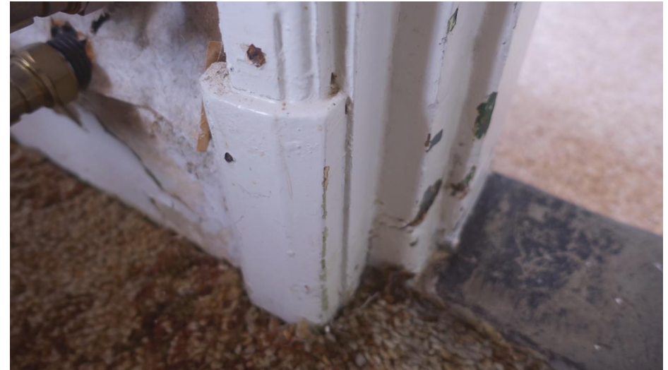
Detail van de houten neuten bij de doorgang van de gang naar de woonkamer. Er zit nog veel verf op diverse onderdelen.
