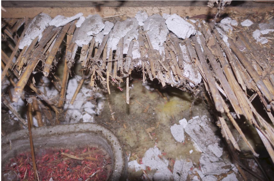
Het oude stucplafond op riet boven de slaapkamer.
