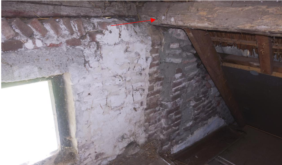
Zicht op de binnenzijde van het muurwerk met klamp aan de zuidzijde van de voorgevel. Bij de pijl is de oude positie van de voorgevel aangegeven, die aan de hand van het pengat in de gebintplaat gereconstrueerd kan worden.
