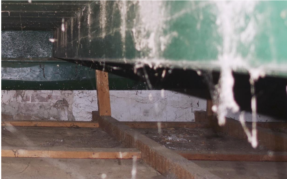
Detail van de oude wandbepleistering tegen de voorgevel, ter hoogte van de woonkamer en de groen geverfde zolderbalklaag.
